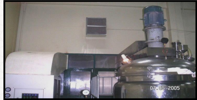
Ventilasi fan dengan saringan
